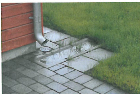
Bild 10. Stuprörutkastare (S:t Eriks)
