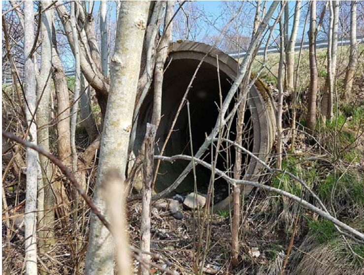
Värdeelement nr 4. Trumma under väg som kan användas som passage för groddjur och smådjur.
