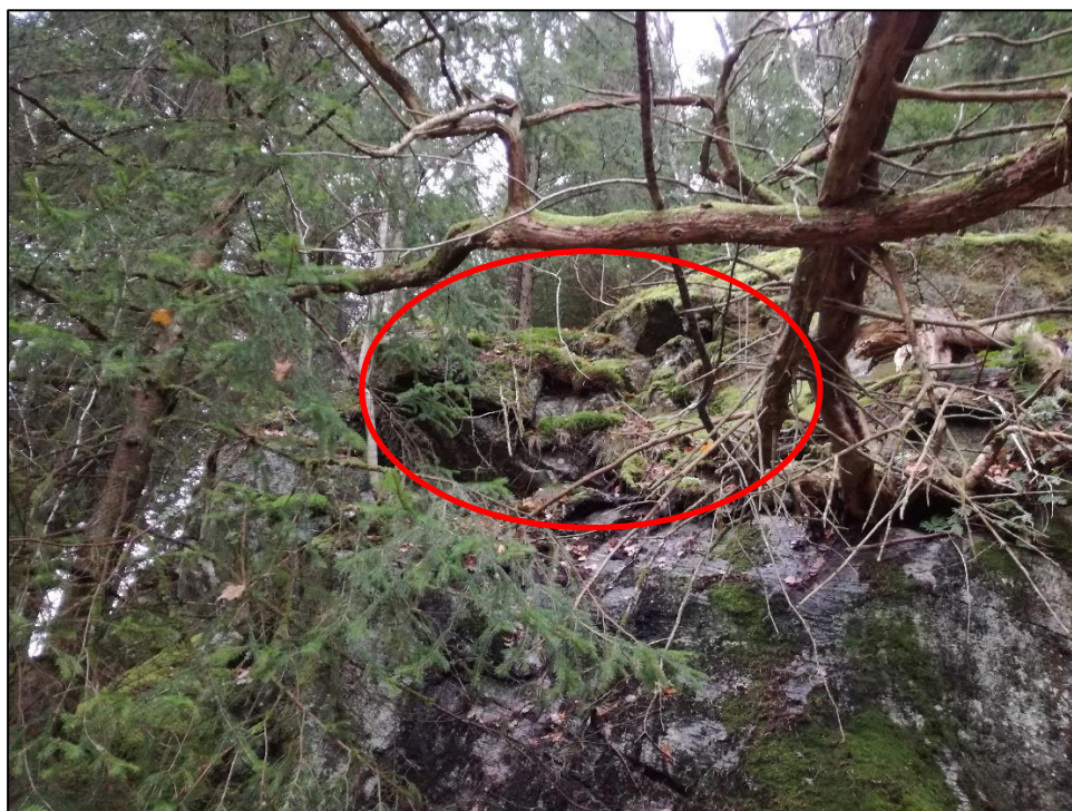
Figur 3: Bergslänten i figur 1 sedd nedifrån. Bergrensning rekommenderas i markerat parti, det större blocket är detsamma som i högra markeringen i figur 1.
