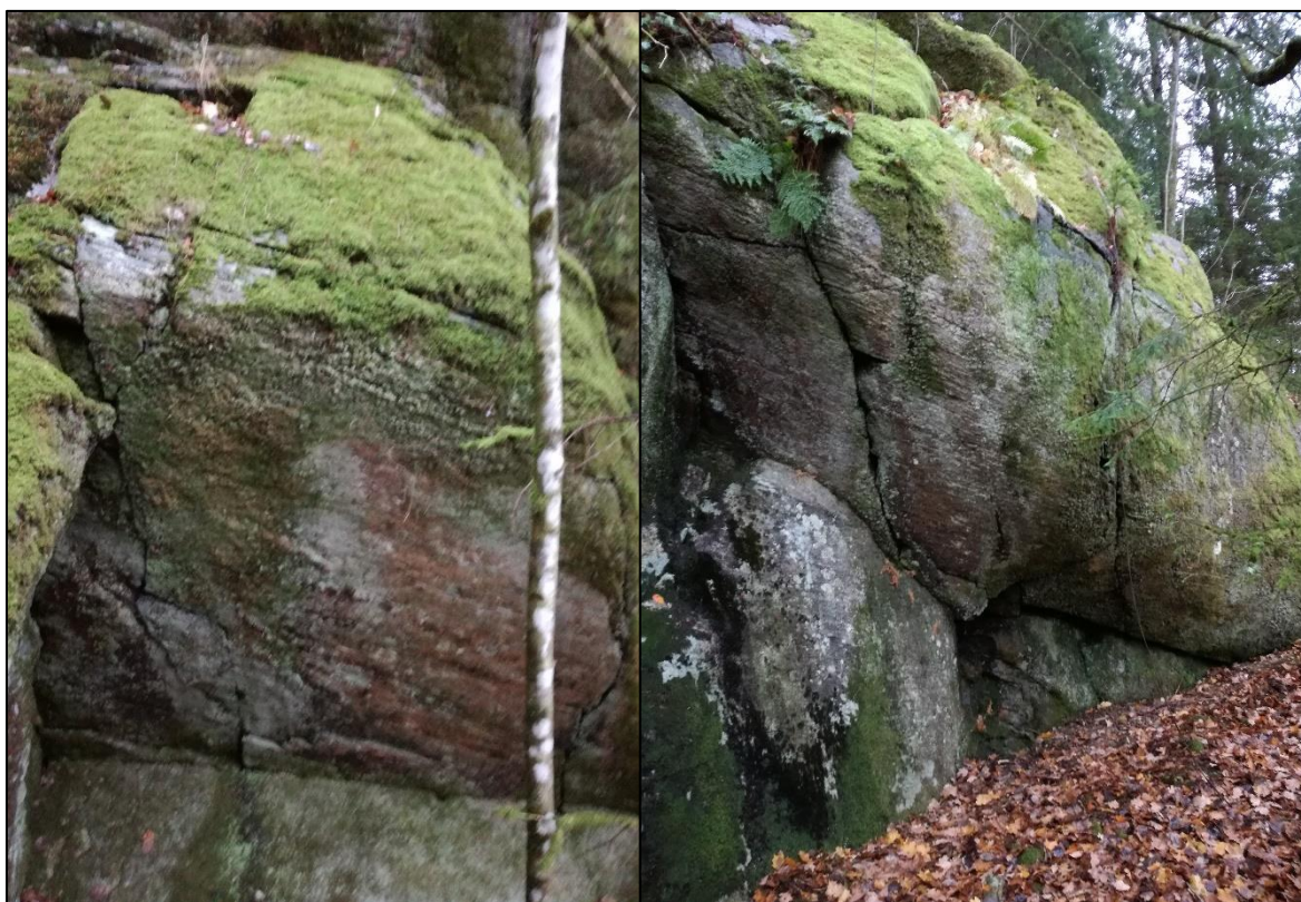
Figur 4: I bergsläntens nedre västra del förekommer 2 st block där bergförstärkning rekommenderas om området för den tilltänkta byggnationen utökas till ett avstånd mindre än 5 meter från bergsläntens fot. Enligt nuvarande detaljplan bedöms dessa åtgärder inte behövas då avståndet till detaljplansområdet ger ett tillräckligt säkerhetsavstånd.
